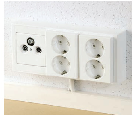
Lopputuloksena saadaan siisti, tarkoituksenmukainen ja asennusmääräysten mukaisesti toteutettu kokonaisuus.
